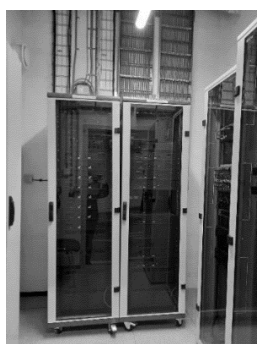
(B) Ústředna nouzového zvukového systému
