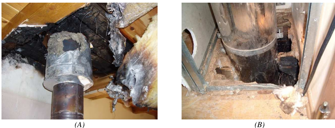
Obr. 1(A), (B) Požáry od prostupů kovových komínů dřevěnou konstrukcí [3] Fig. 1 Fires from metal chimney through a wooden structure [3]
